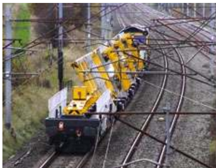
↑ Minimalna wysokość ładunku zapewnia swobodny przejazd pod przewodami trakcji
